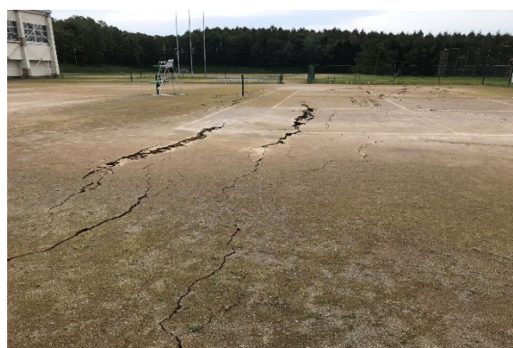
早来中学校 校庭の地割れ
