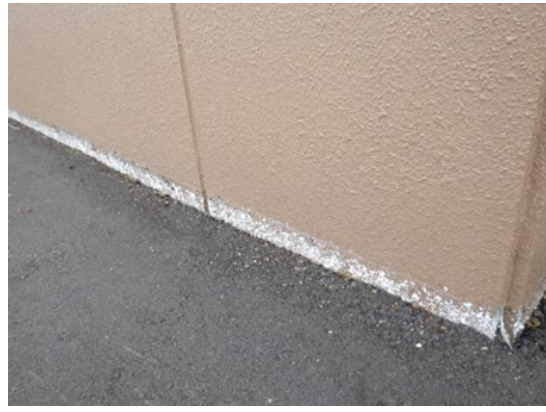
総合庁舎（前駐車場沈下）
