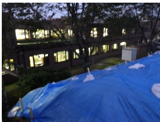
既存庁舎裏（のり面 地割れ・膨らみ）
