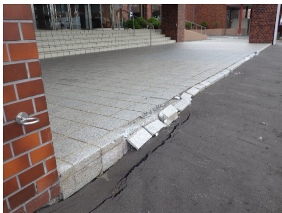
正面玄関入口（地割れ・沈下）
