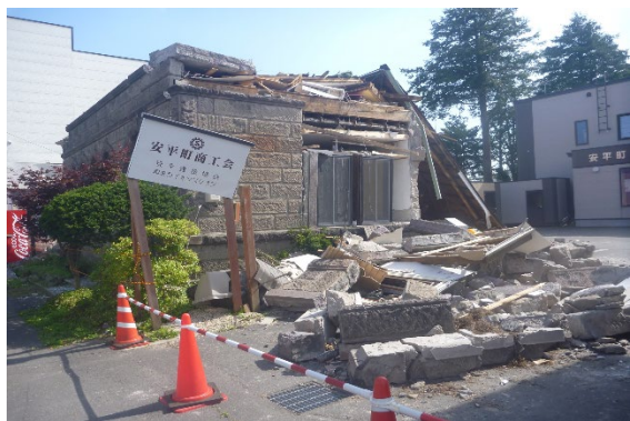
商店街における被害～安平町商工会
