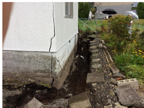
早来大町地区（揺れによる家屋移動）
