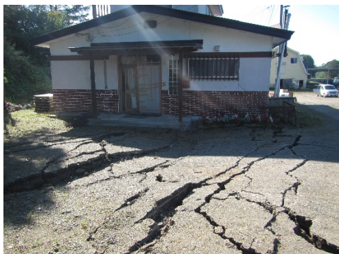
早来守田地区（住宅の下における地割れ）
