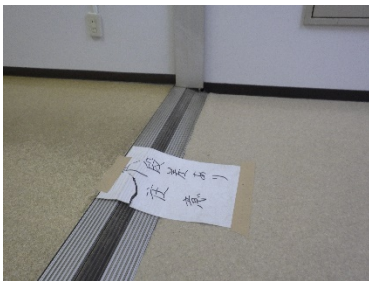
総合庁舎（既存庁舎 沈下 45mm）
