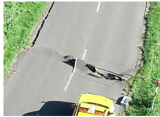
地震により隆起した道路。町内いたるところで交通障害が発生した。
